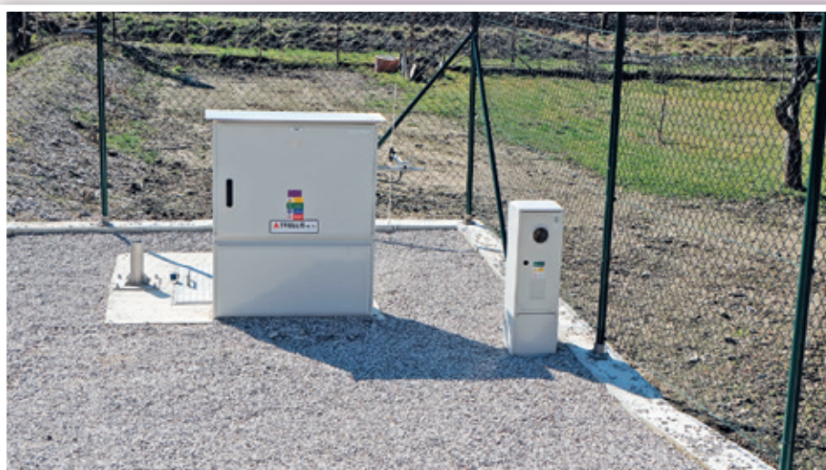
Čerpacia stanica odpadových vôd
